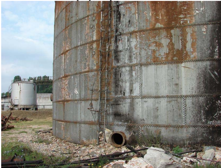
фиг. 1 Състояние на резервоара преди ремонта
