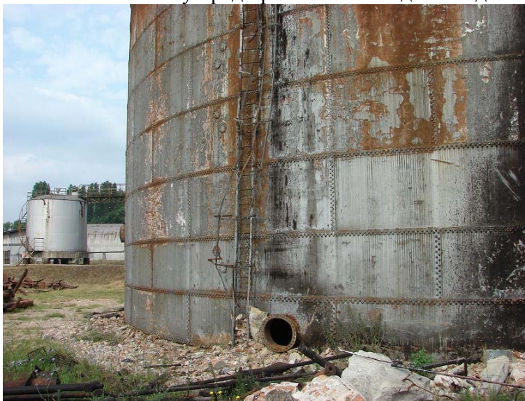
фиг. 1 Състояние на резервоара преди ремонта
