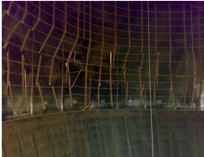
фиг. 4 Част от разрушената поддържаща скара
